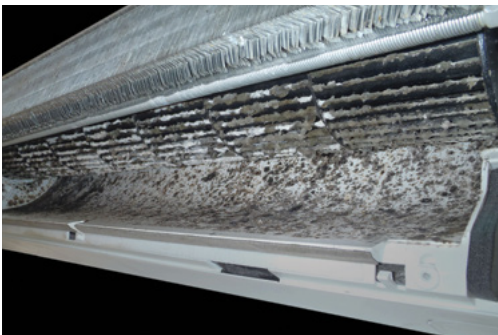
El moho prospera en las ruedas del ventilador mini-split
